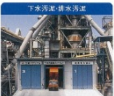
下水汚泥・排水汚泥 汚泥処理設備 下水汚泥や排水汚泥を、筒形炉で高温密閉した状態で安定して大量に処理を行っています。
